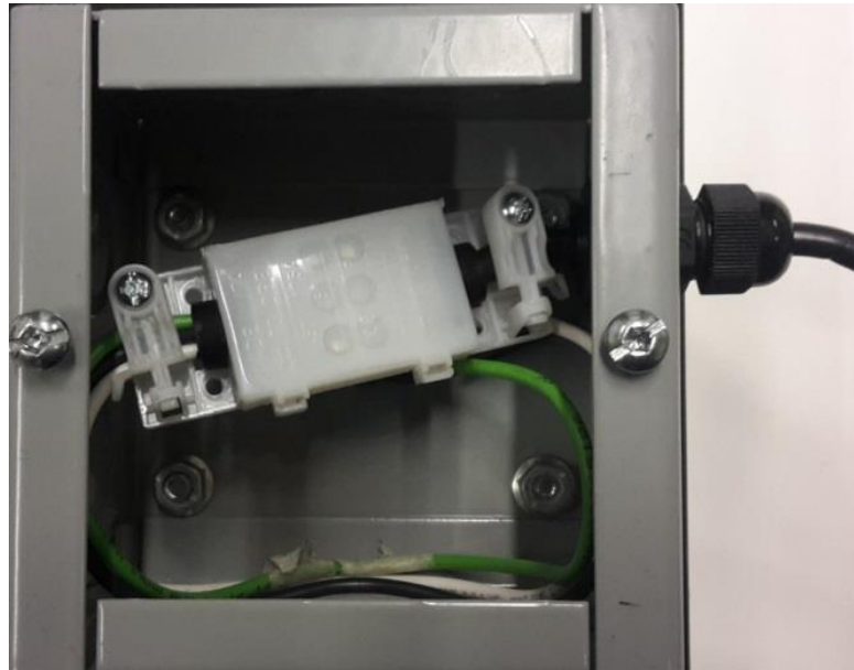
Fig. 44 Branchements électriques finis dans le projecteur 74-00013-01.
