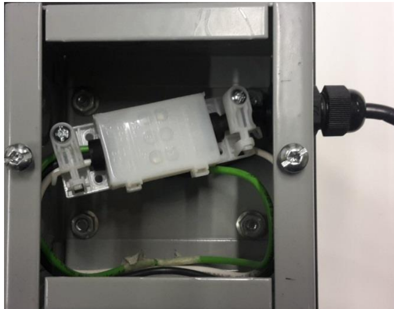
Fig. 50 Collegamenti elettrici finiti nel proiettore 74-00013-01
